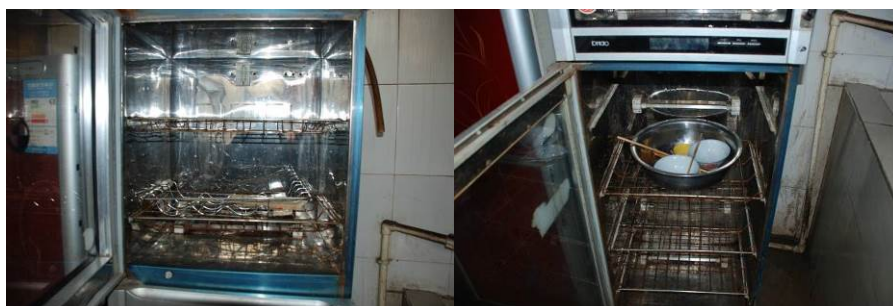
图 11 消毒柜未接电正常使用,
