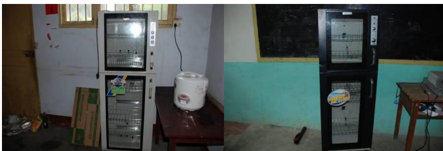
图 7 设备未正常使用
