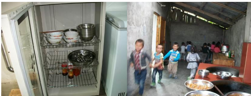
图 10 消毒柜（漏电，已停止使用）
