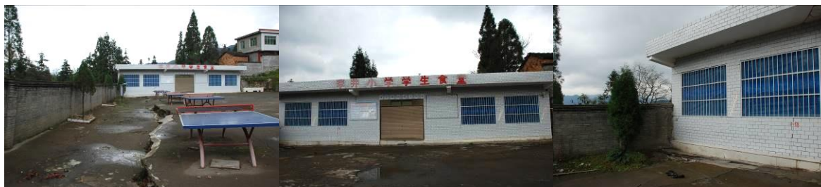
图 3 学校食堂因地基下沉，墙体开裂已停止使用
