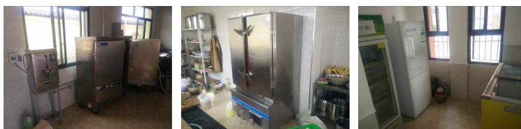
图 15 正常使用的厨房设备组图
