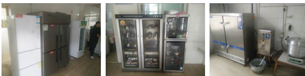
图 16 正常使用的厨房设备组图
