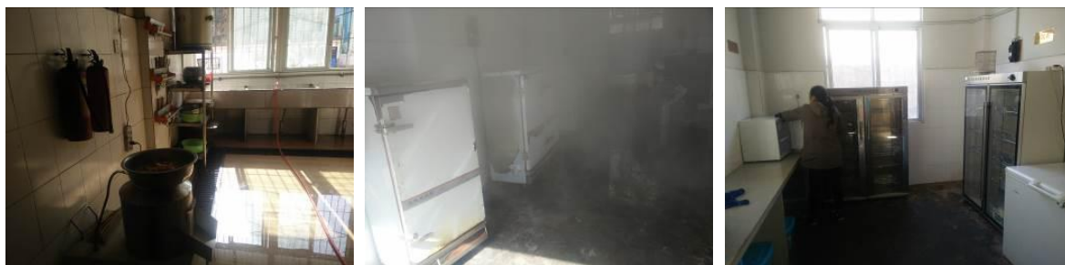
图 15 正常使用的厨房设备组图
