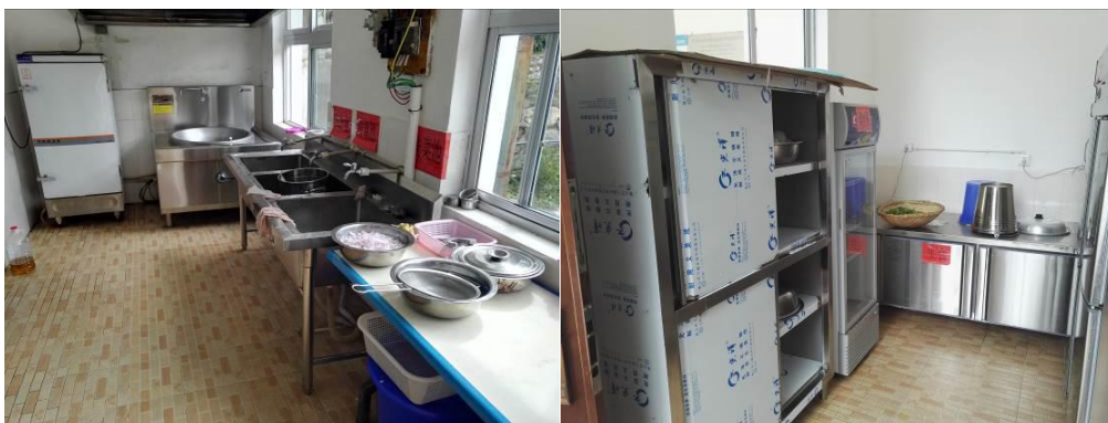
图 4 厨房卫生情况组图
