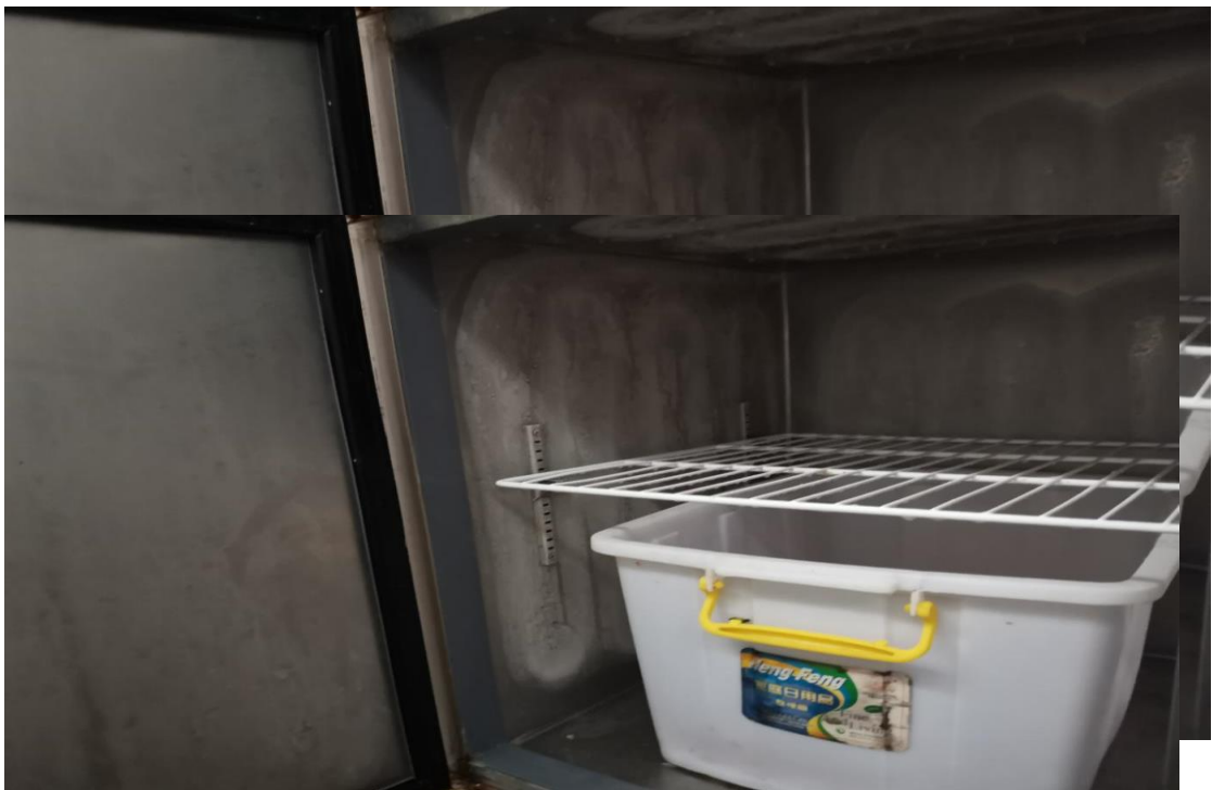
清理储藏柜冰块已清除
